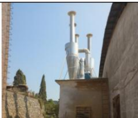
1#、2#旋风除尘+排气筒-图三
